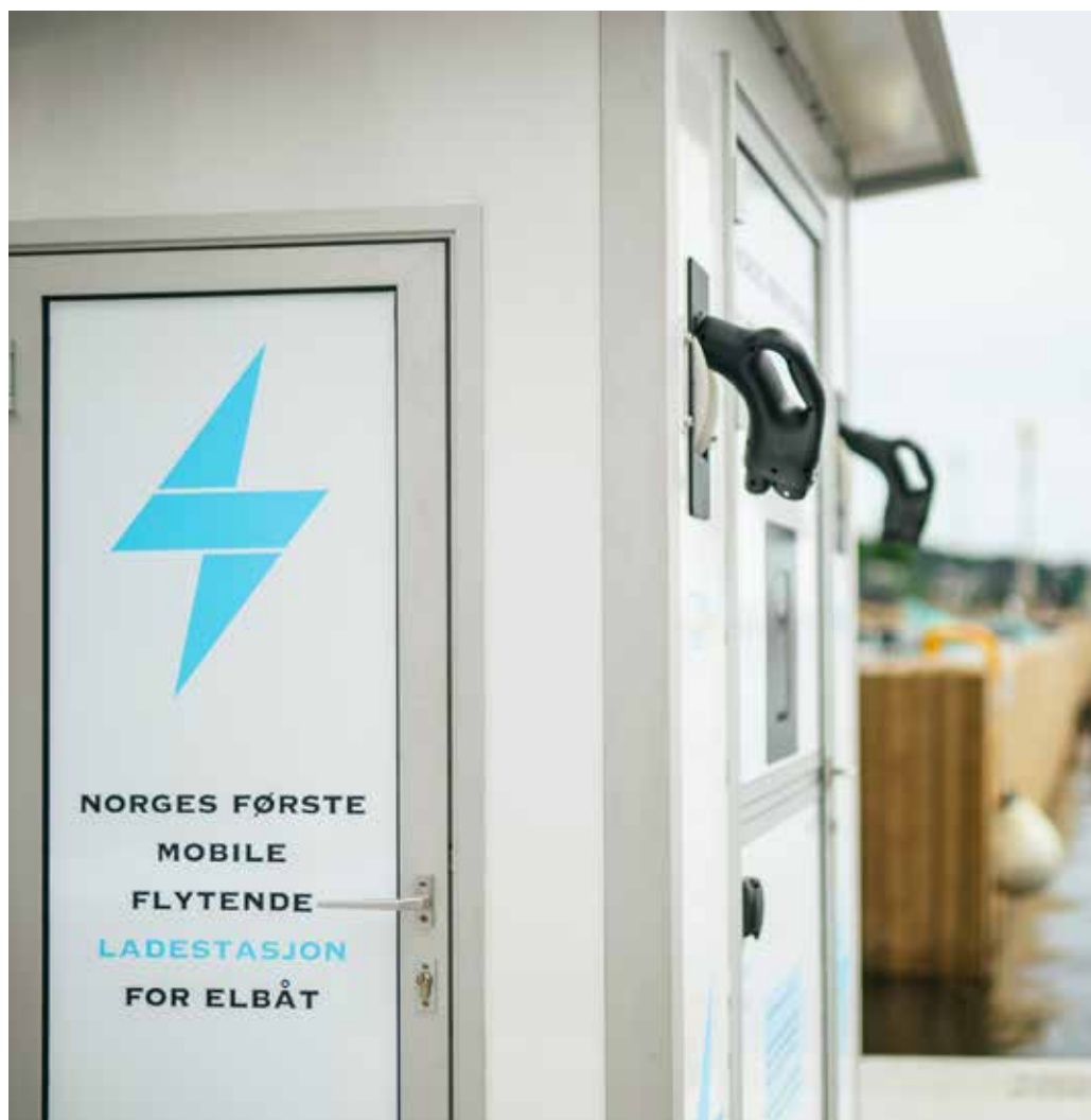
Arendal havn har installert Norges første mobile flytende ladestasjon for elbåter i Pollen i Arendal. Foto: Lydløs/Scream Media.
