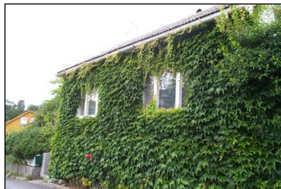
"Arkitektens trøst" skjuler eternittplater som er lagt på et gammelt hus.
