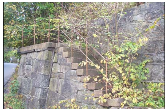
Trapp som har stått ubrukt i mange år.
